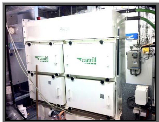
Figure 12 : Caissons de filtration à charbons actifs sur un réseau de ventilation, avant rejet à la cheminée
