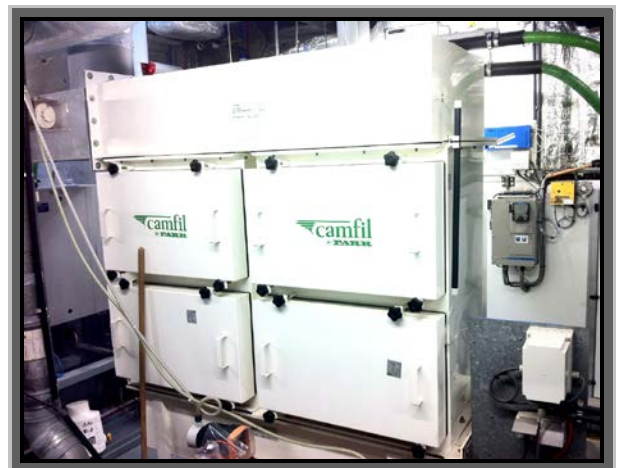
Figure 12 : Caissons de filtration à charbons actifs sur un réseau de ventilation, avant rejet à la cheminée
